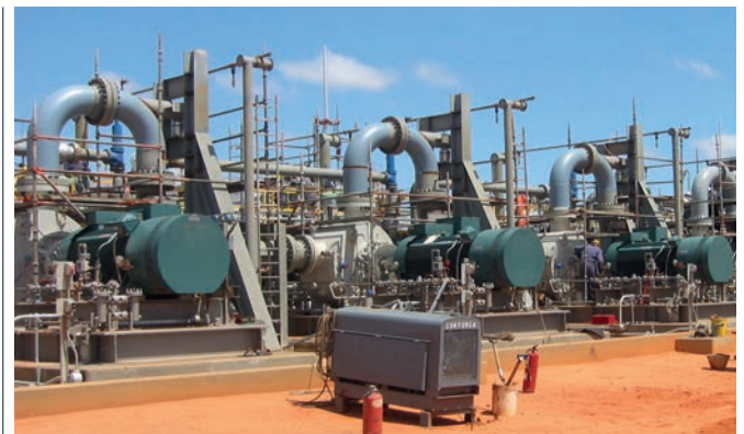
Estación de Sistema de bombeo multifásico MW 10
