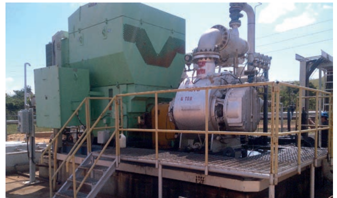
Sistema de Bombeo Multifásico en el campo Petrozuata, Venezuela
