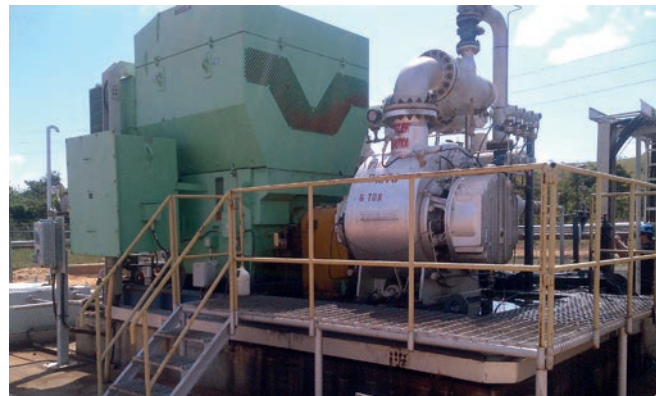
Мультифазная насосная система на нефтяном месторождении Петрозуата
