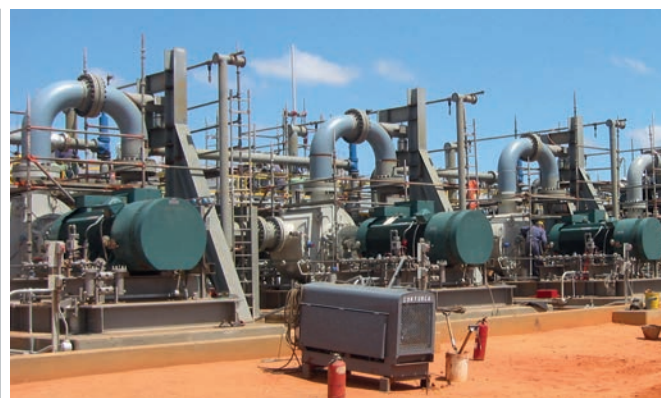
Блочная модульная насосная станция с мультифазными насосами модели MW 10
