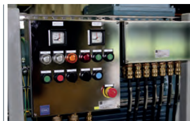
通过就地控制面板进行开关操作
