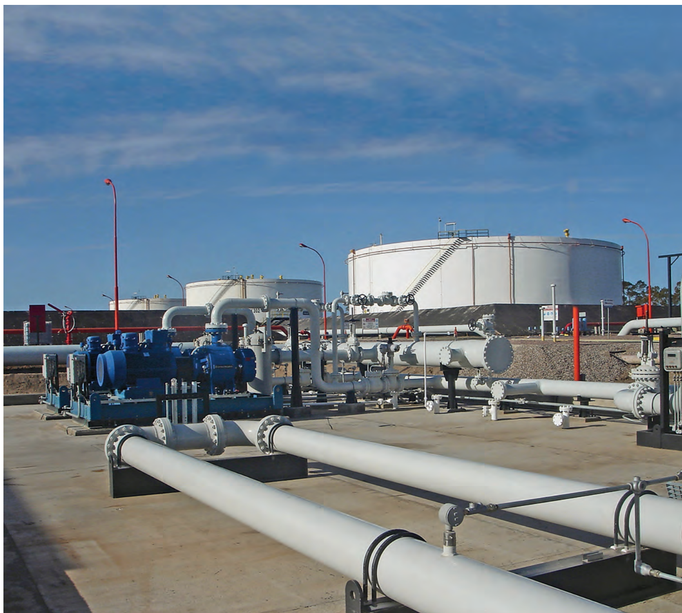
阿根廷的陆上油库罐区
